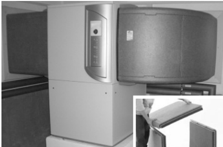
Luftwärmepumpe Innenaufstellung mit neuen Kanälen in Amtsberg / Schlößchen
